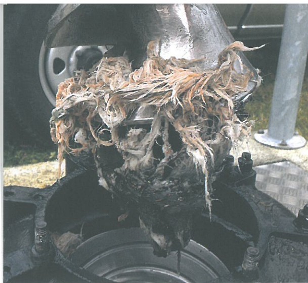
Verstopfte Pumpen, aufwändige Instandstellung.
